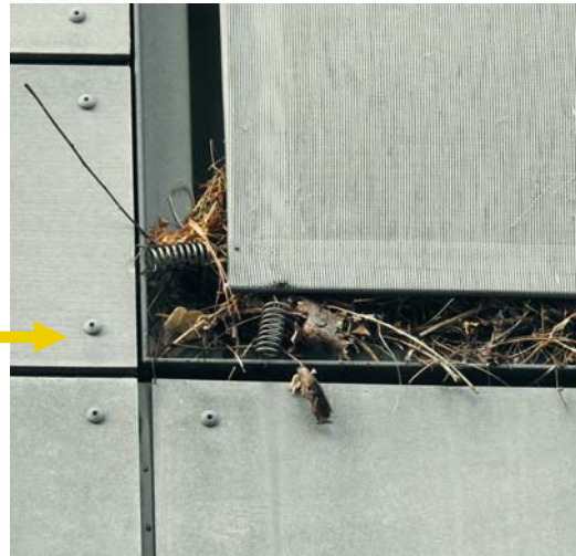
Nistmaterial hinter teilweise loser Fassadenverkleidung im Bestand.
